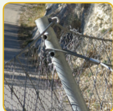
Poteaux des filets anti-éboulement 2
